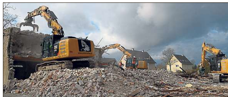
Großesatz: Mit gleich drei Baggern wurden die Gebäude an der Ecke von Westfalenweg und Strothweg abgerissen.
