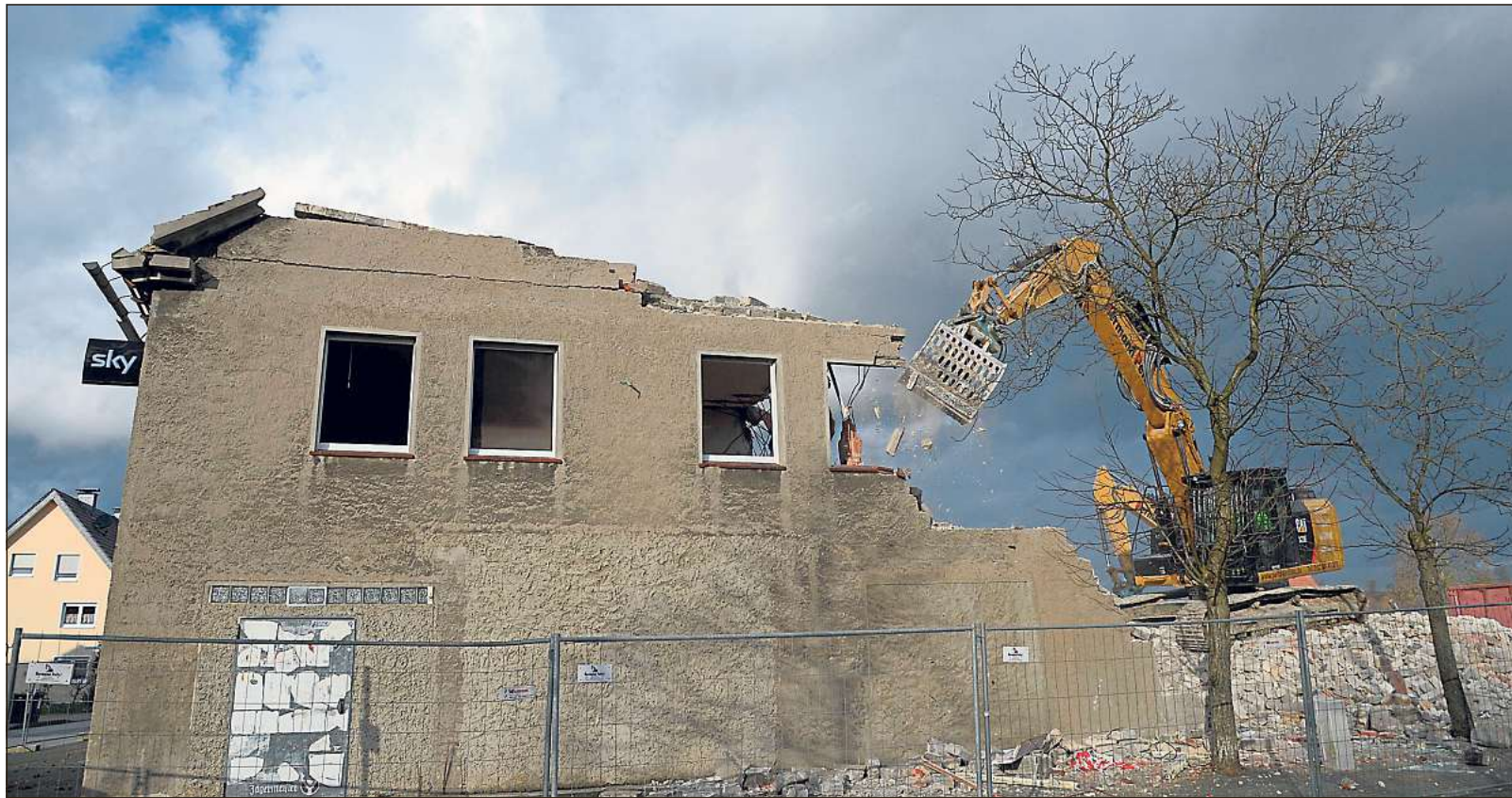
Unerbittlich frisst sich der Bagger von der Firma Peitz in das Gebäude. Die Gaststätte Sielhorst ist Geschichte. Dort entstehen in den nächsten Monaten Wohnhäuser. Bilder: Steinecke
